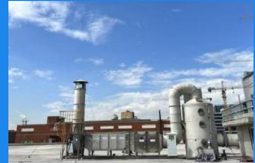
公司治理 VOCs减排装置
