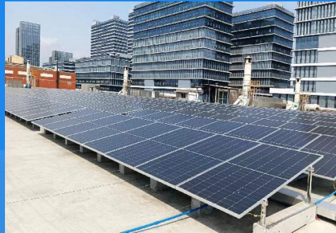
可持续发展管理 光伏发电
